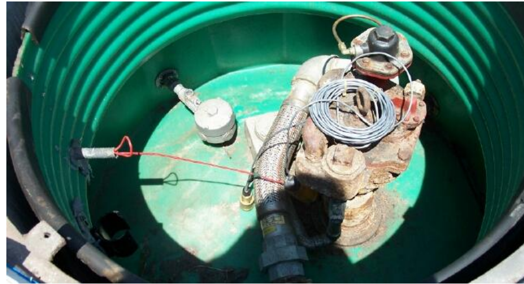
Unsealed electrical conduits
